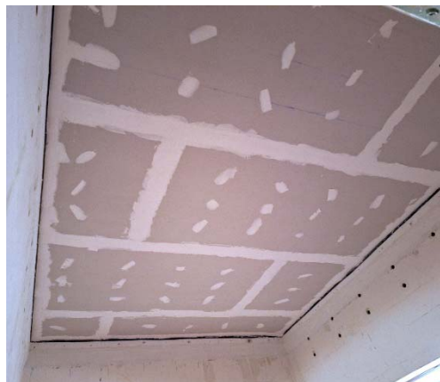
Fotografie des Prüfgegenstands in den Akustikkammern
