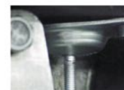
Rotura varilla M6
