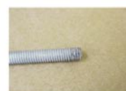
Rotura varilla M8
